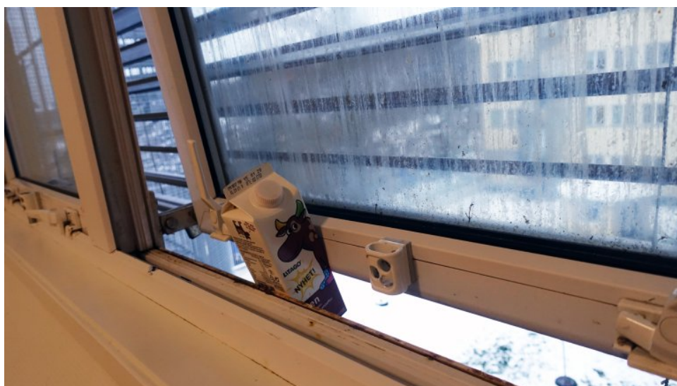
Vinduene på skjermingsenhet var skittene og manglet vedlikehold. Foto: Ukom
